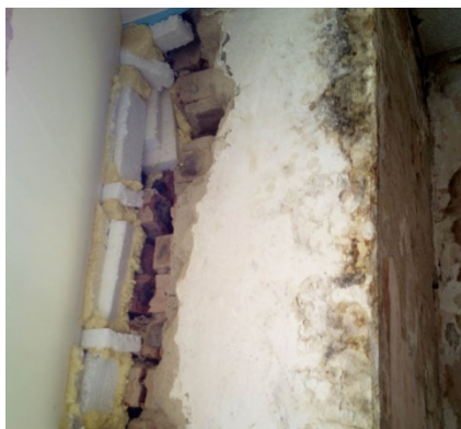
Рисунок 2. Вертикально ориентированная трещина расслоения простенка несущей стены (вид со стороны откоса окна)
