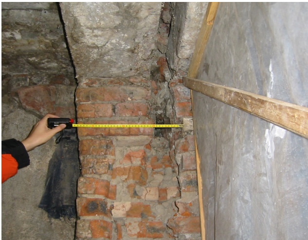
Рисунок 4. Расслоение несущей стены с образованием вертикально ориентированной трещины (вид со стороны откоса окна)
