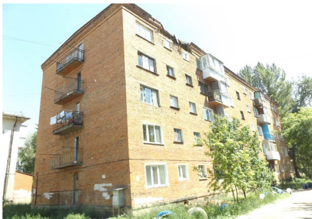
Рисунок 1. Общий вид кирпичного дома с обрушением фрагмента кладки наружной несущей стены
