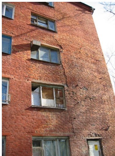
Рисунок 3. Деформация выпучивания кладки несущей стены
